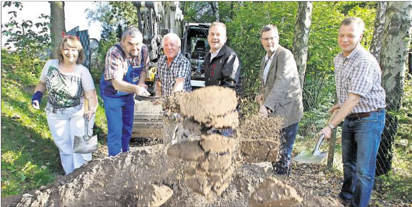
Symbolischer Spatenstich in den Steinigten Äckern: Bürgermeister Richard Rossel (3. von rechts) vollzog den Baustart gemeinsam mit Ralf Wenzel, Niederlassungsleiter der ausführenden Firma Eurovia, und den Stadträten Lutz Köhler, Horst Beuthe, Matthias Langenhan und Walburga Reinhardt (von rechts). Bauroth
