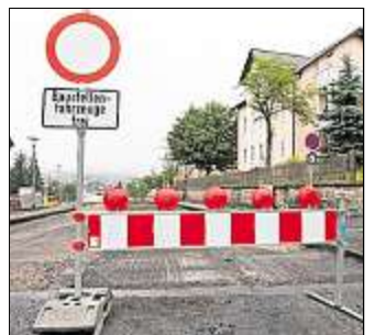
Die Gräfenrodaer Straße in Oberhof ist noch gesperrt.
